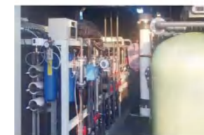
東營港污水處理廠中試系統
