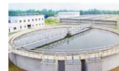
商丘水務有限公司污水處理廠一角
