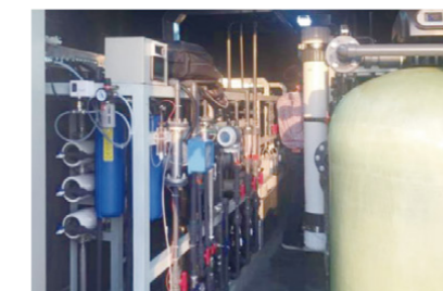
東營港污水處理廠中試系統
